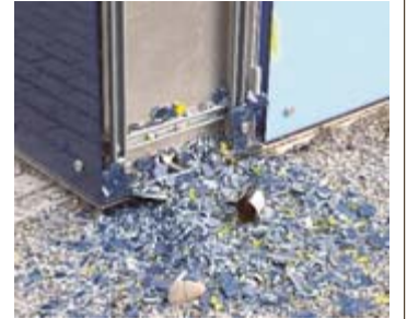
Zerstörte Glasverkleidung am WC-Häuschen im Herosépark. LANGE
